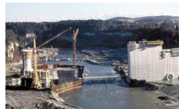
Der Bau des Wasserkraftwerks Anfang der 1960er-Jahre bedeutete einen mächtigen Eingriff in die Landschaft.
